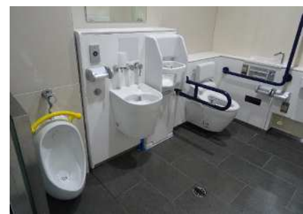
▲八千代緑が丘駅の多機能トイレ
